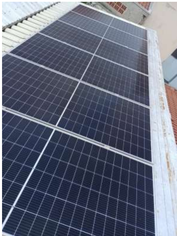
Figura 3: Módulos fotovoltaicos instalados
